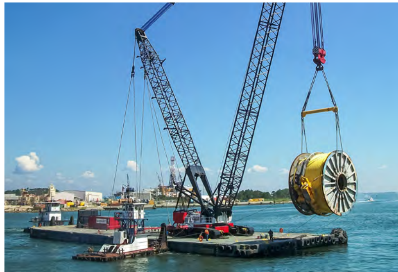
Auch nach 42 Jahren quicklebendig: Big Al auf der Barge im Hafen Port of Mobil, Alabama.
