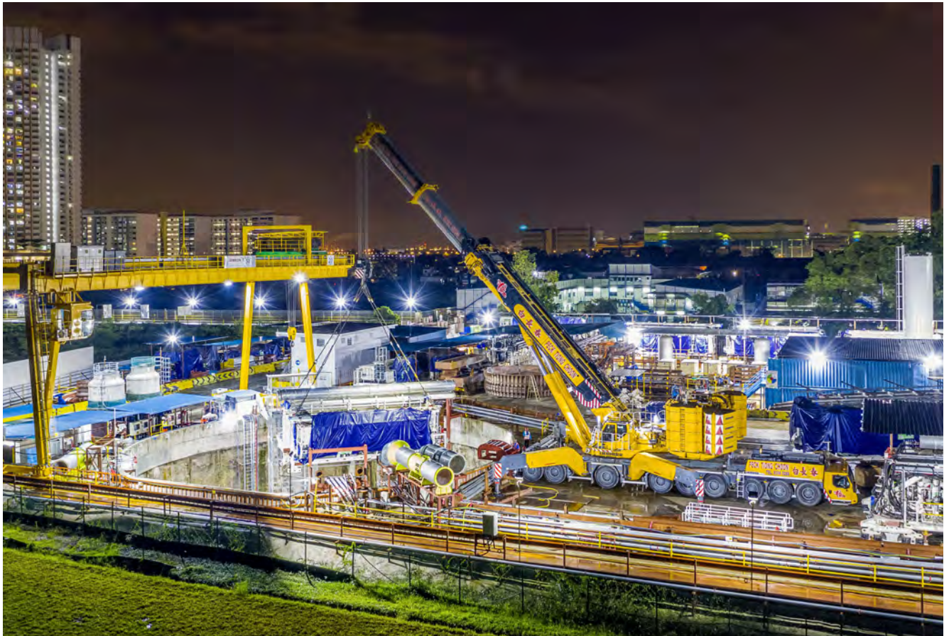
Nachtschicht: Ein LTM 1750-9.1 beim Beschicken einer Baustelle für ein gewaltiges Tunnel-Projekt der Mega-City, das in 60 Meter Tiefe das Regenwasser der Metropole sammeln soll. Peck Tiong Choon Leasing betreibt 16 Liebherr-Krane in Singapur.
