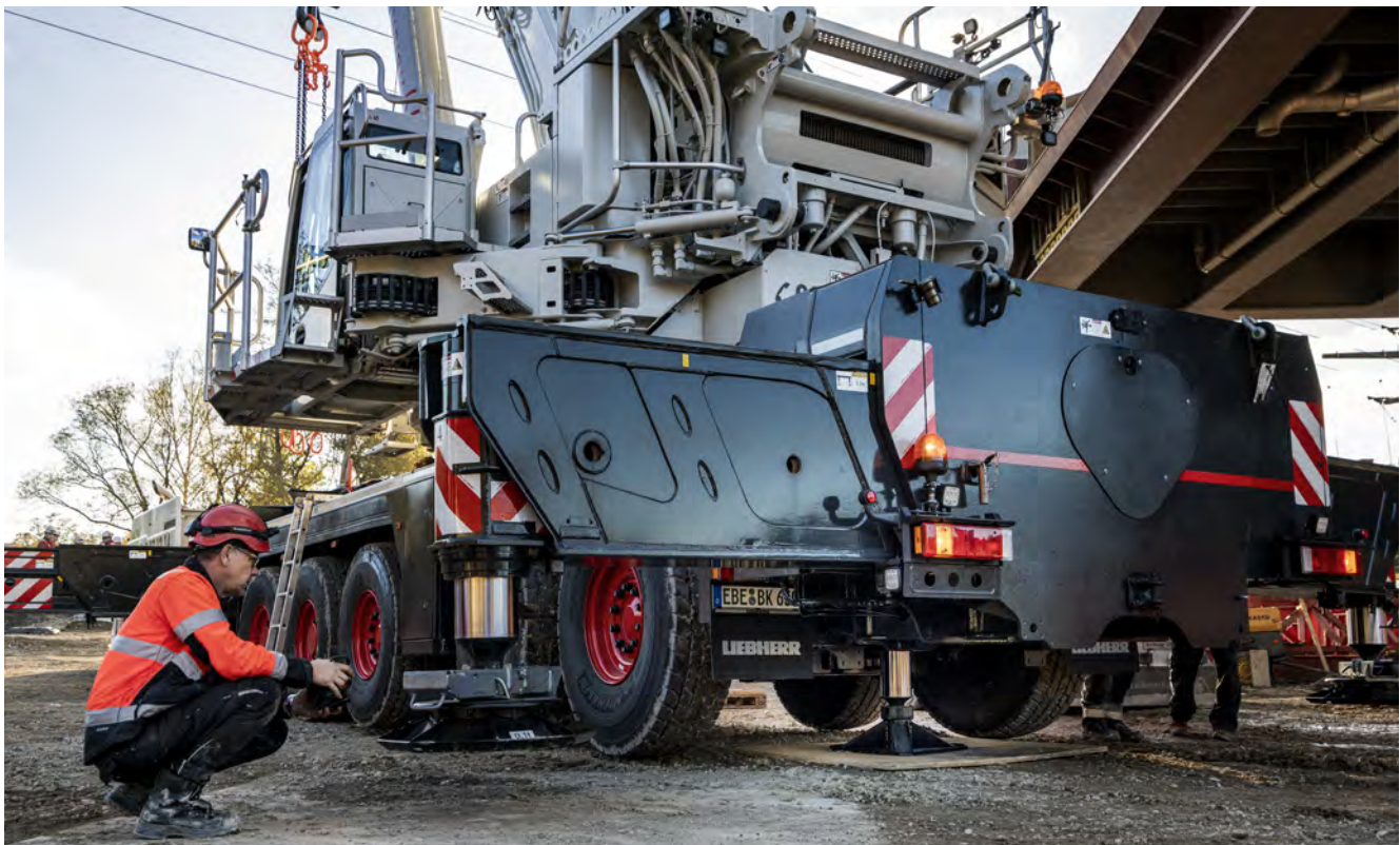
“In dreißig Minuten steht der Kran auf seinen vier Stützen.“ BKL-Mitarbeiter und Fahrer Steffen fährt nach getanem Job per Fernsteuerung die Kranabstützungen in den Schiebehelmkasten. Unter dem Heck ist deutlich der fünfte Abstütz-Zylinder zu erkennen. Der LTM 1650-8.1 erledigt die Montage des Abstützkastens selbst und benötigt keinen Hilfskran dafür.
