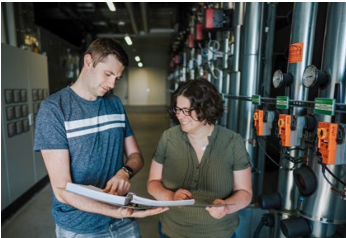
Christian Wölfle und Sophie Gantert überprüfen die Wärmemengenzähler des Heizungsverteilers der Kantine.
